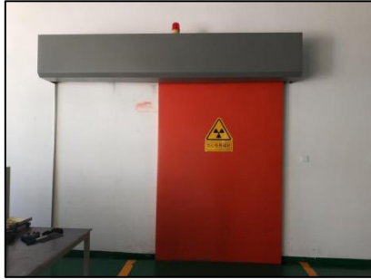
外层防护门“当心电离辐射”警示标识、工作状态指示灯
